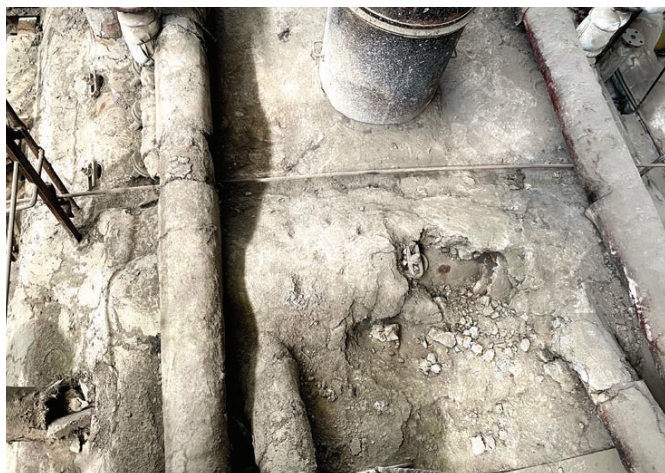
Лючки верхних коллекторов котла ДКВР-20/13
