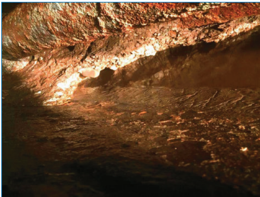
Рисунок 5. Нижние дымогарные трубы котла в накипи.
