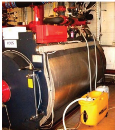
Рис. 3. Химический бустер малой мощности, используемый для химической промывки котла LOOS
